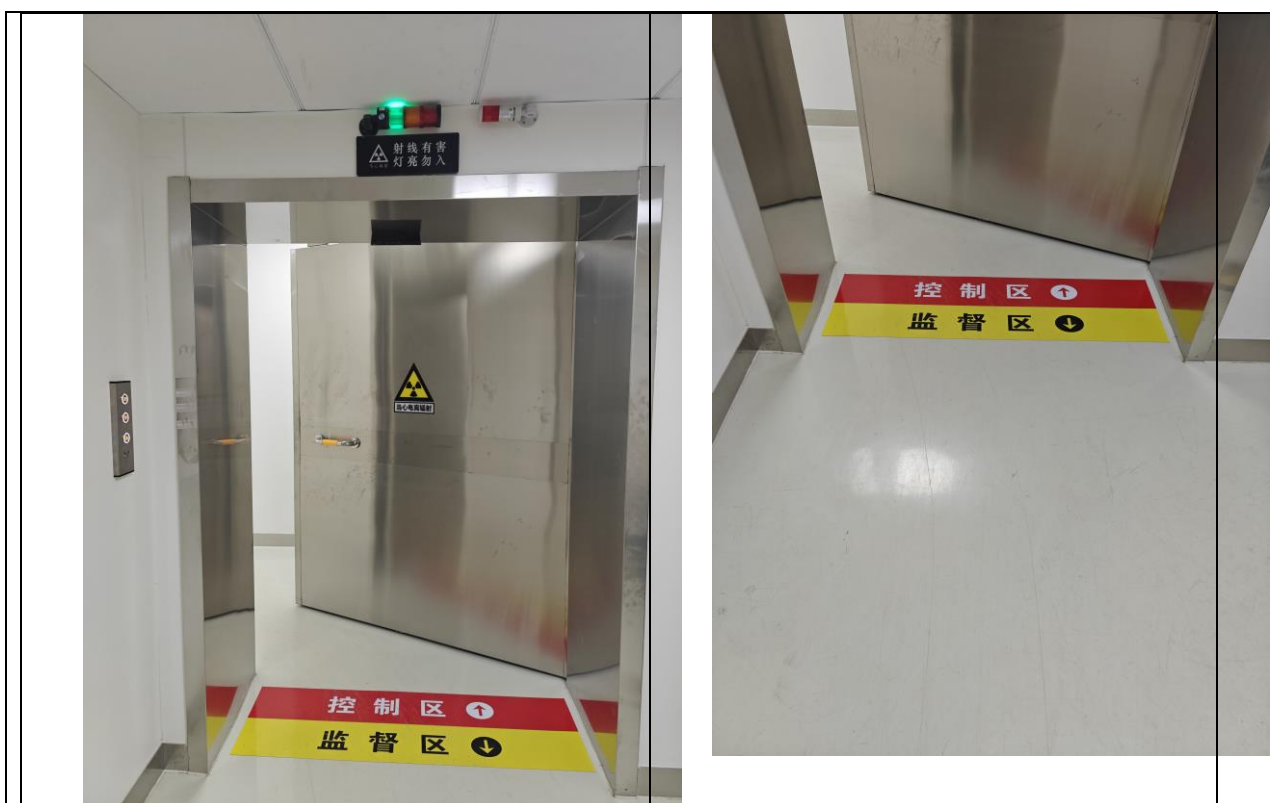
图 3-2 医用电子直线加速器机房分区标识张贴
