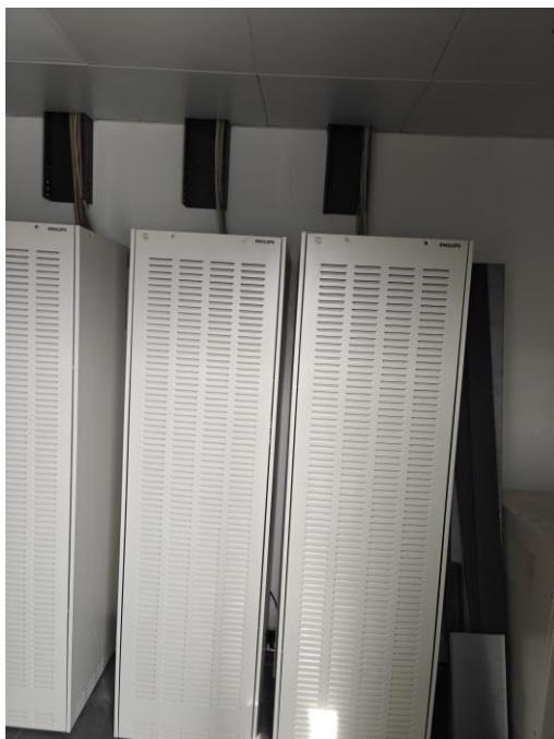
西侧设备机房
