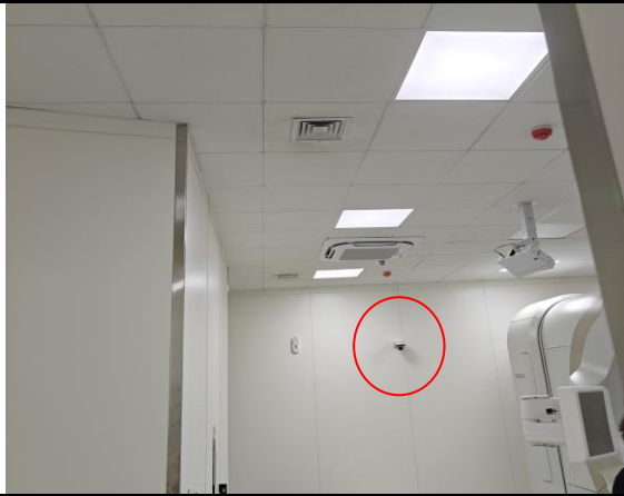
南墙急停及西墙监控
