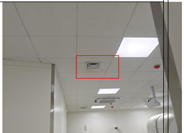
机房内送风口
